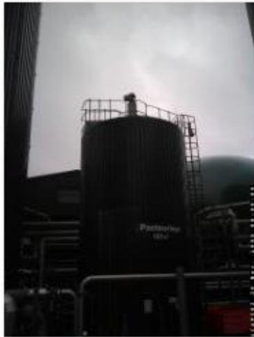
P22 Pasteuriser tank
