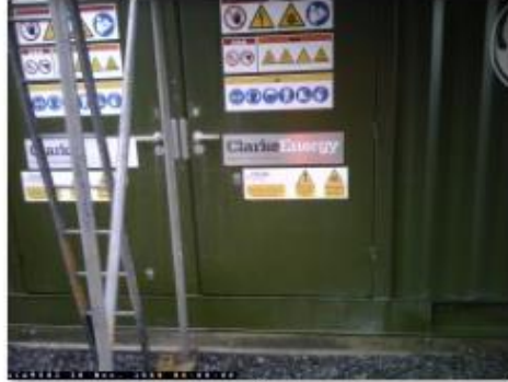
P53 CHP unit signage
