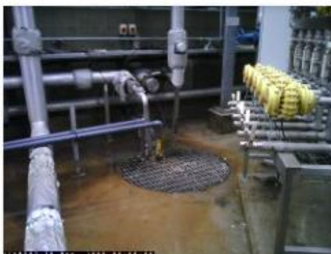
P29 condensate sump
