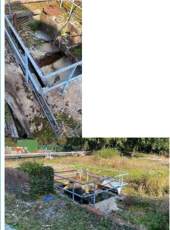
Discharge Point B.
