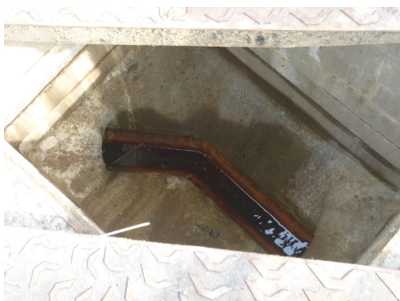
Photo 2: Final effluent discharge pipe
