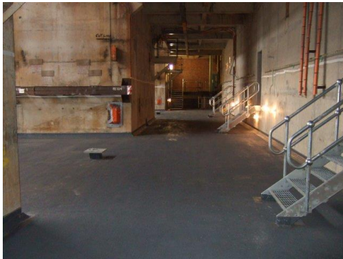
Shield Cooling Fan Room
