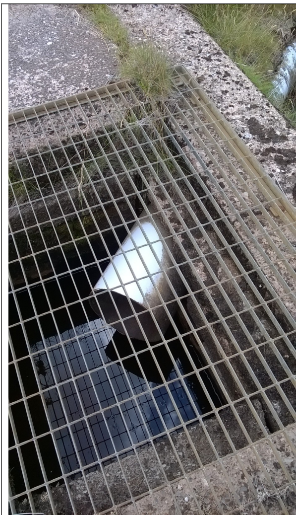
Nant y Foel Ddu intake pipe
