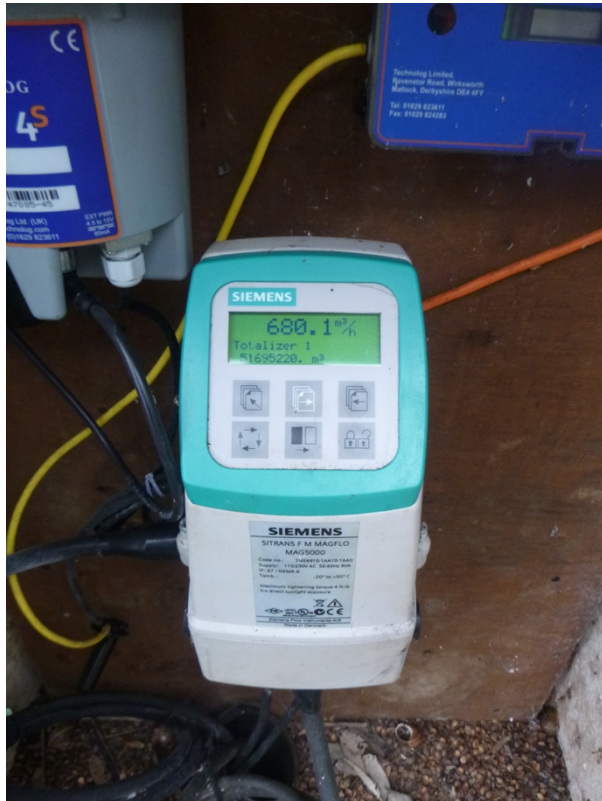
Figure 2: Meter at Llechryd.
